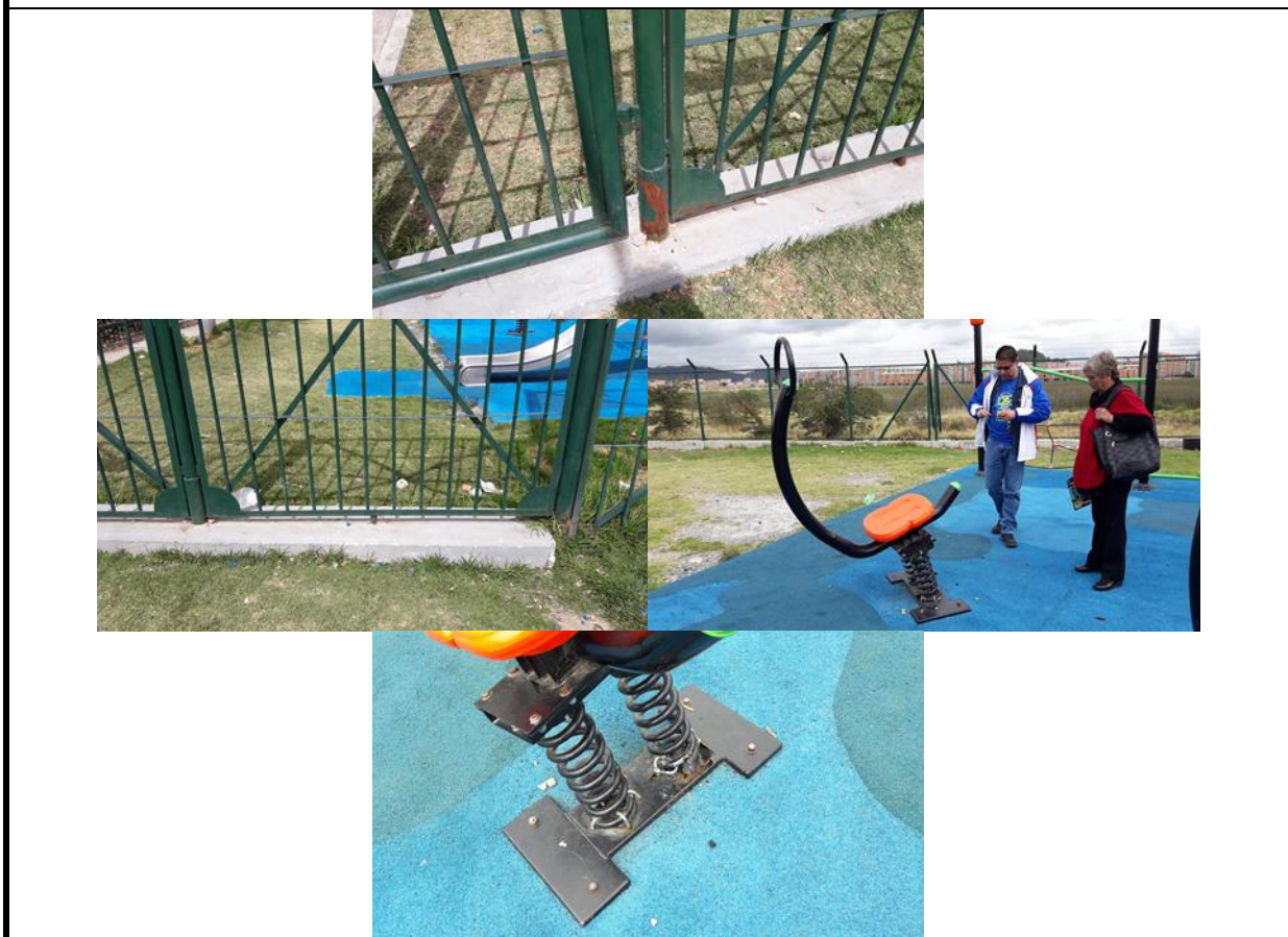
CTO. 509 de 2017. Vista detalle cerramiento nuevo h= 2.5m; se observan piezas con principios de oxidación, en los "Saltarines", se observa evidencia de maltrato presuntamente por la comunidad usuaria, elemento desaplomado y con lamina de anclaje a piso deteriorada y fracturada.
